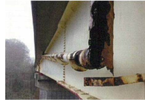
塗装鋼管の発錆状況
